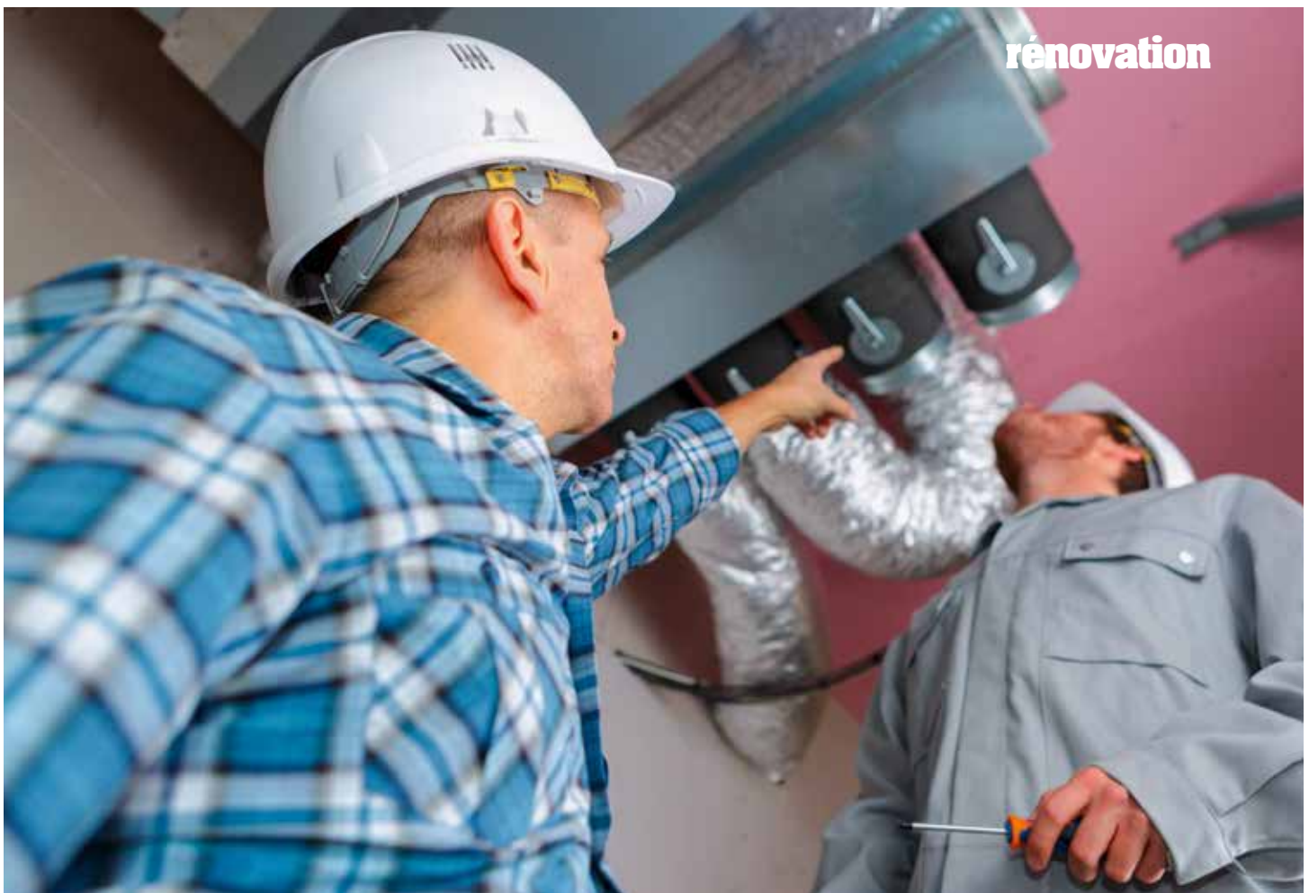
Un système CVS (chauffage, ventilation et sanitaire) bien étudié permet de remédier à l'effet «thermos» d'une étanchéité excessive.
